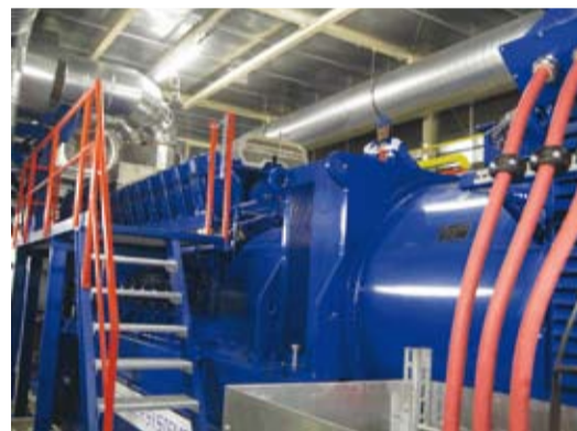
3,9-MW-BHKW der MWM sichert das GuD-Kraftwerk in Münster bei Netzausfall ab
