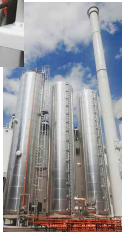
Die Pufferspeicher steigern die Flexibilität
