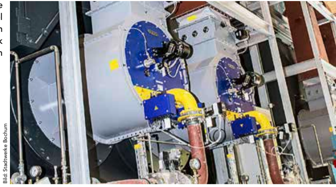
Blick auf die Erdgaskessel im neuen Heizkraftwerk Bochum
